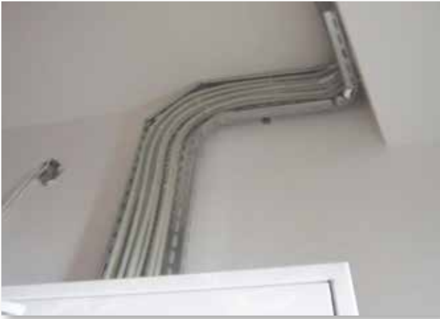
Kablolar bina içerisinde tek bir kanala döşenirler.
