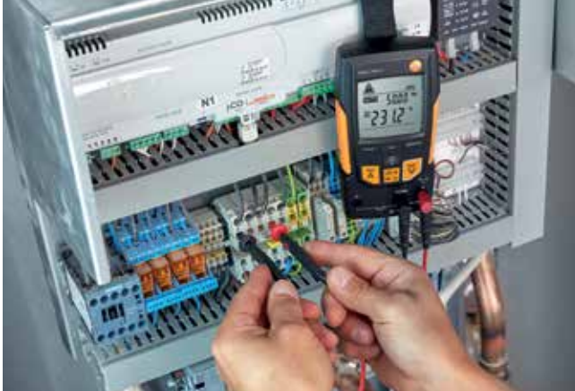
Bir ısı pompasının şalt dolabında gerilim testi
