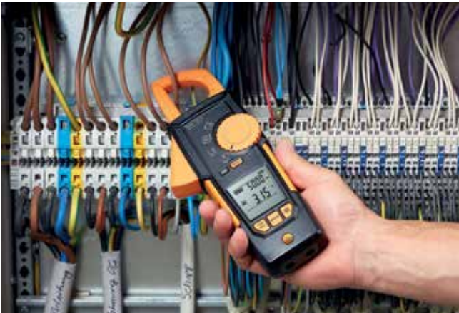
Şalt dolabında akım ölçümü
