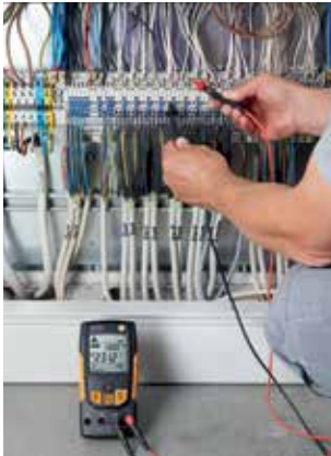
Şalt dolabında gerilim testi
