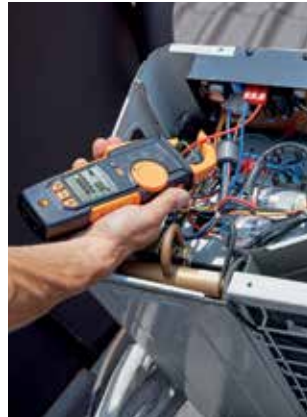
Bir dış soğutma ünitesine pens ampermetreyi takma
