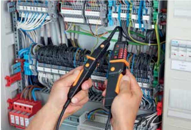
Şalt dolabında gerilim ölçümü
