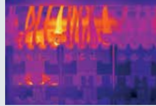
Sistemlerin bakımı: Devre kesiciler ve elektriksel bileşenlerdeki aşırı yüksek sıcaklıkları arıza oluşmadan belirleyin.
